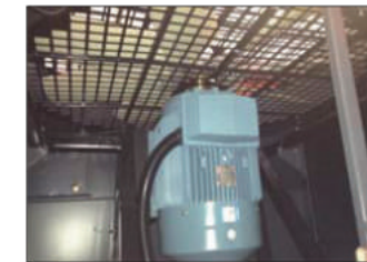
Fan and fan motor
